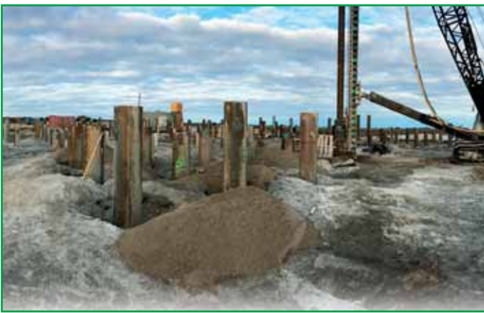
Audet & Knight s'est avantageusement positionnée au Nunavut, où elle a dû développer une logistique différente pour le forage de pieux dans le pergélisol. La location de main-d'œuvre occupe une large part de ses activités dans l'Arctique.
